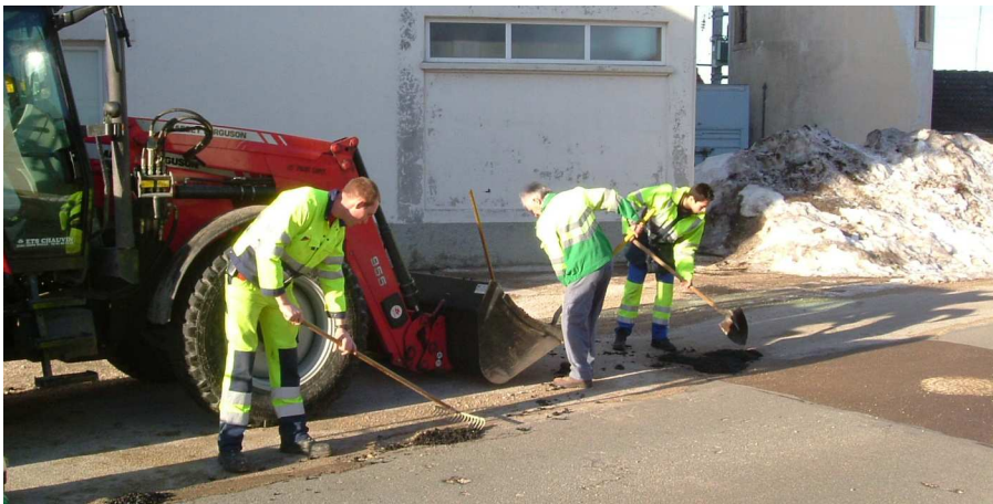
Il faut réparer la chaussée qui a souffert.
